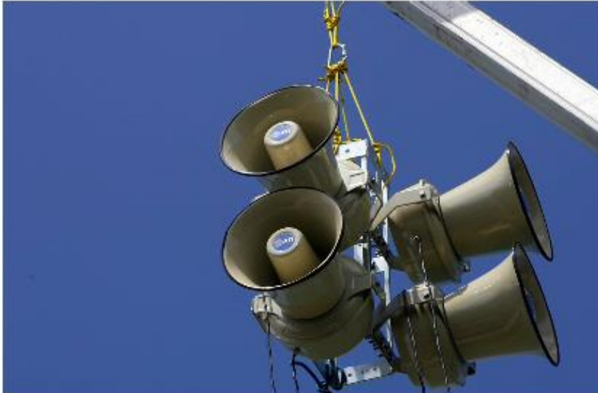
Altoparlantes de las sirenas de alerta de emergencia por un aviso de tsunami. (GFR Media)
